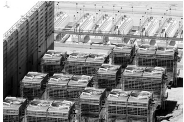
Las unidades de enfriamiento de computadora y memorias de NSA en Bluffdale, Utah, consumen 6 millones de litros diarios de agua.
